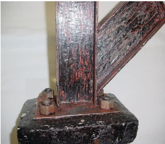
Aspecto da estrutura após 3000 horas de exposição à nevoa salina e remoção do revestimento
